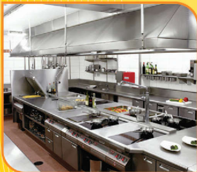
Hút mùi thông gió bếp công nghiệp Ventilation hood industrial kitchen 換気フード工業用キッチン
