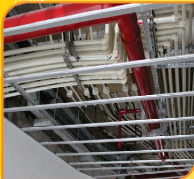
Tư vấn, cung cấp, thi công lắp đặt hệ thống đường ống cứu hỏa Consulting, supply, construction and installation of piping systems fire コンサルティング、供給、建設、配管システムの火のインストール
