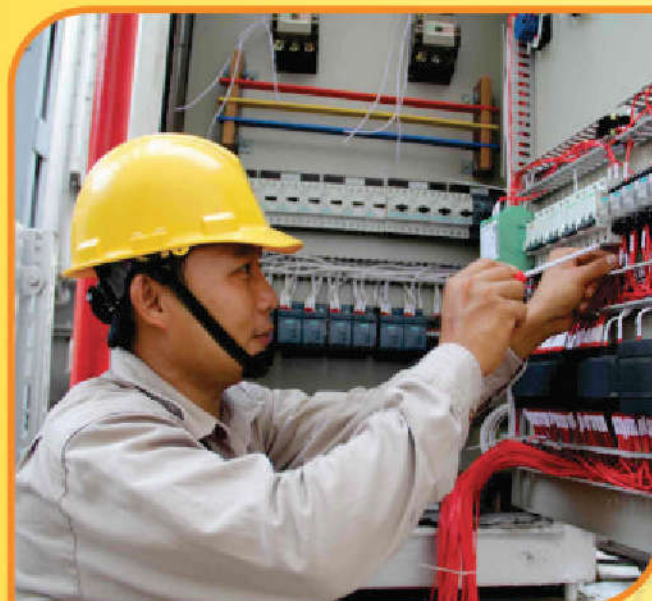
Tư vấn, cung cấp, thi công lắp đặt hệ thống điện công nghiệp Consulting, supply, construction and installation of industrial electrical systems コンサルティング、供給、建設、工業用電気システムの設置
